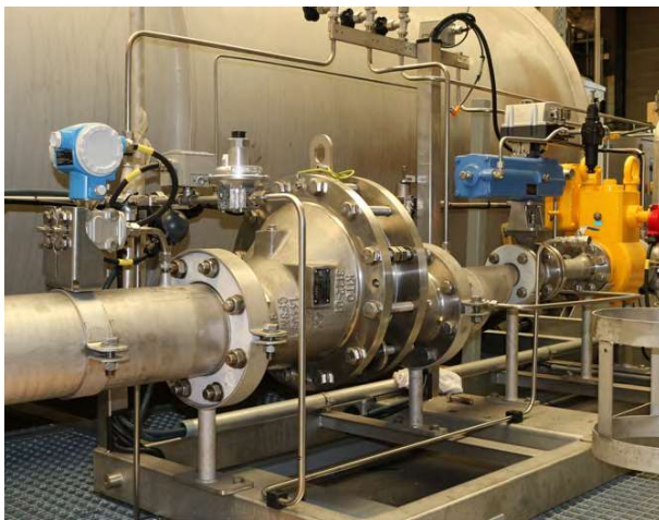
Hoog temperatuur fakkel-straat met RVS vlamdover, Endress+Hauser flowmeter, drukmeter en level switches.
