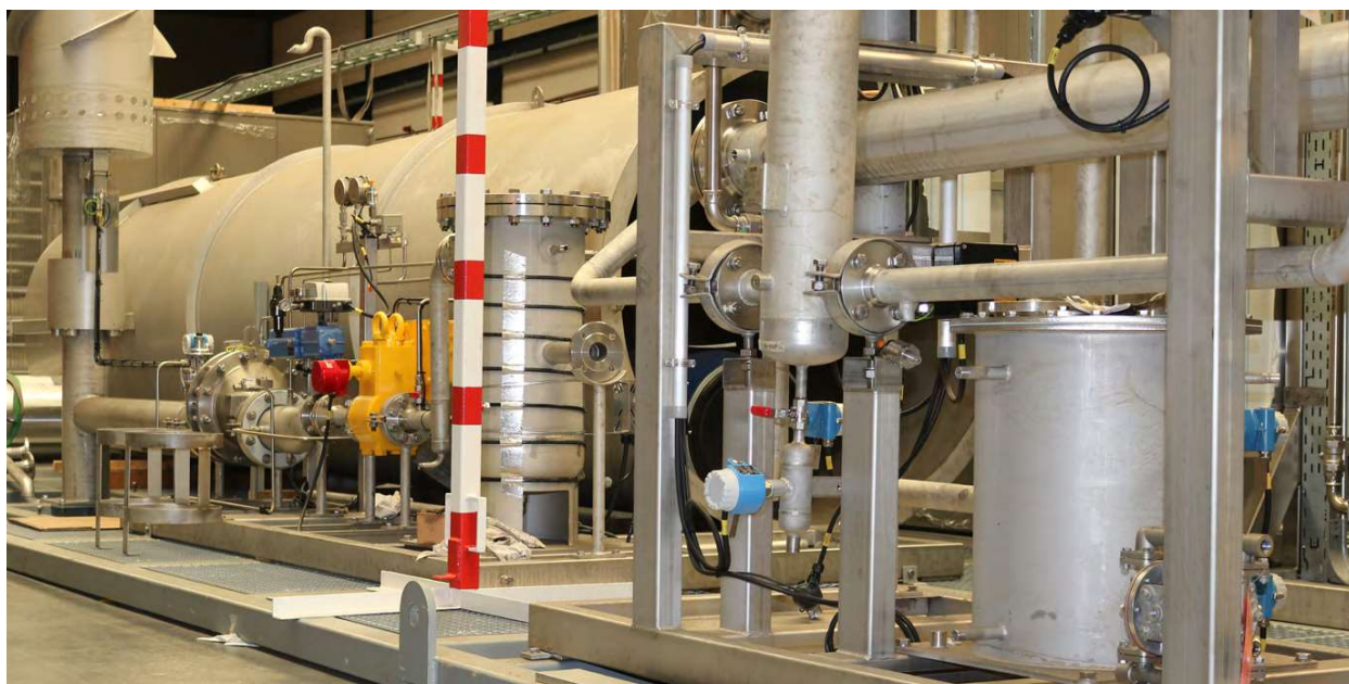
Droger en fakkelininstallatie van de MGTP
